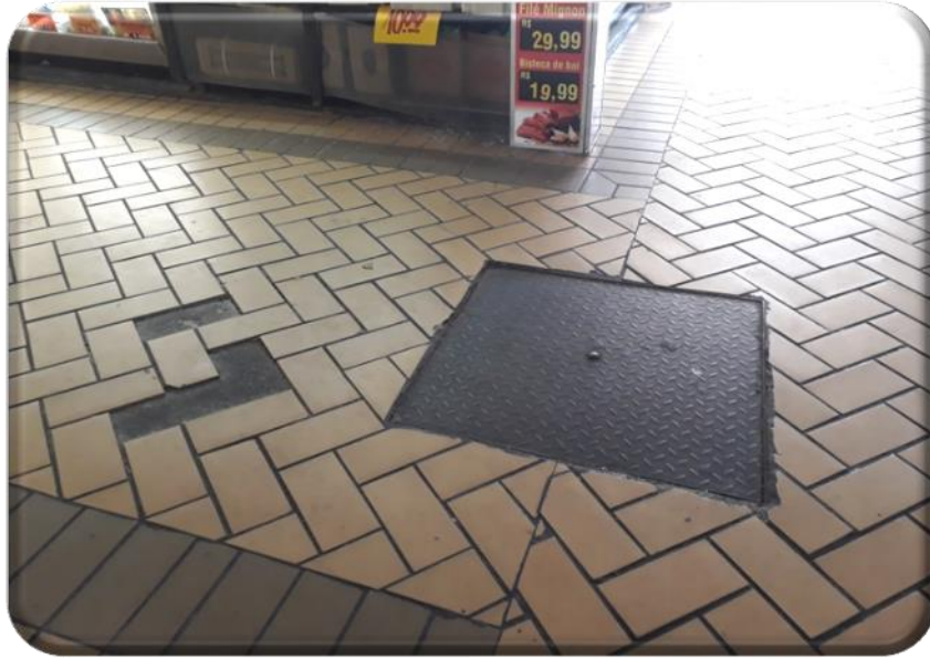
Figura 13: detalhe do piso interno com peças faltantes e tampa com desnível.
