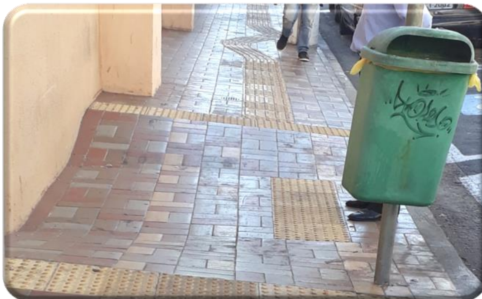
Figura 15: detalhe do desnível e do mau posicionamento da lixeira.
